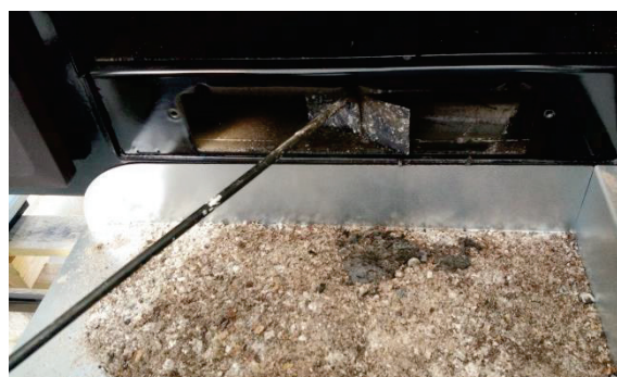
Figura n°20 - Accesos para la limpieza de la salida de humos.
